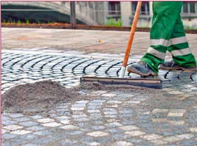
Verarbeitung des ROMEX® Pflasterfugenmörtels | Application of ROMEX® pavement fixing mortar | Izvajanje del z malto za fugiranje tlakovanih površin
