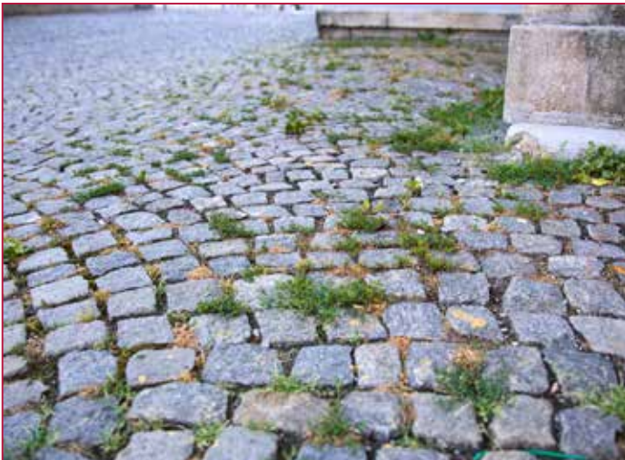
Fläche vor der Sanierung mit Unkraut Durchwuchs | Surface before repair with weed growth | Nefugirana tlakovana površina s plevelom
